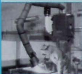
Stationäre Rauch- & Staubabsaugung
