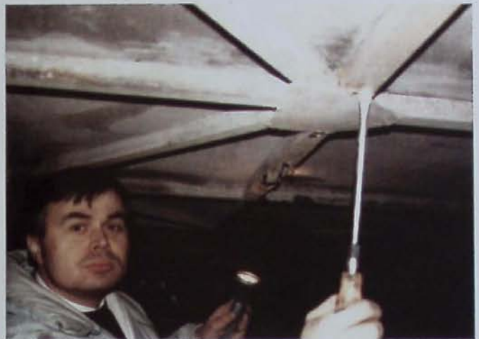
Sachverständiger der Landesprüfanstalt (Ing. SEIS) begutachtet Rostschäden an tragenden Teilen.
