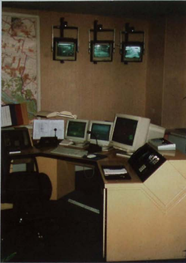
Funkplatz Kanal 10 mit Verkehrskameras, rechts oben das Steuerpult zur Kameraauswahl und Steuerung
